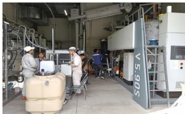
水素製造実証の様子
