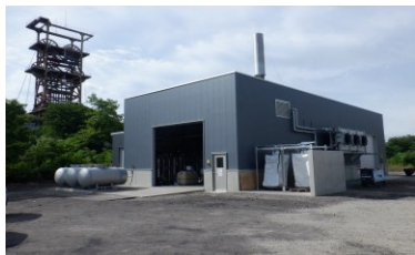
水素製造プラント
